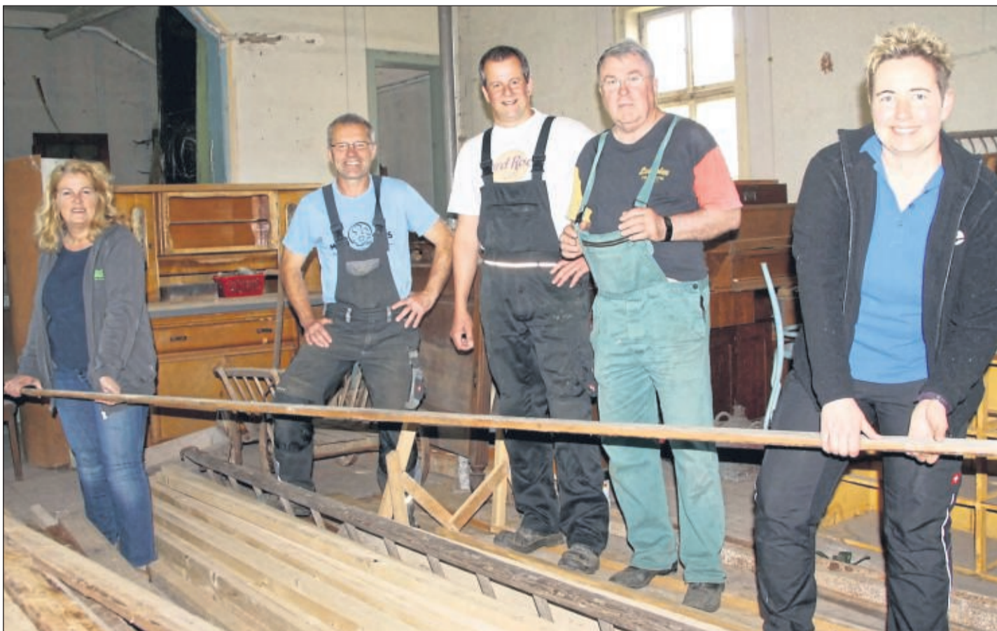
Gemeinsam stark: Mit vereinten Kräften bringen die Hönebacher Fachwerkfreunde das Haus wieder in Schuss, auch wenn wie hier im großen Saal noch jede Menge Arbeit wartet. Von links: Elisabeth Linß, Siegfried Linß, Bernd Mausehund, Dr. Kurt Schreiner und Christina Wolf.
