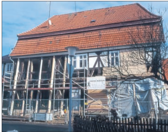
Objekt Niemeyer: Zustand vor den Renovierungsarbeiten. Foto: nh
